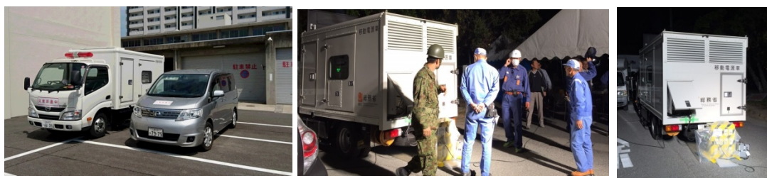
(移動電源車(写真左)の外観)
